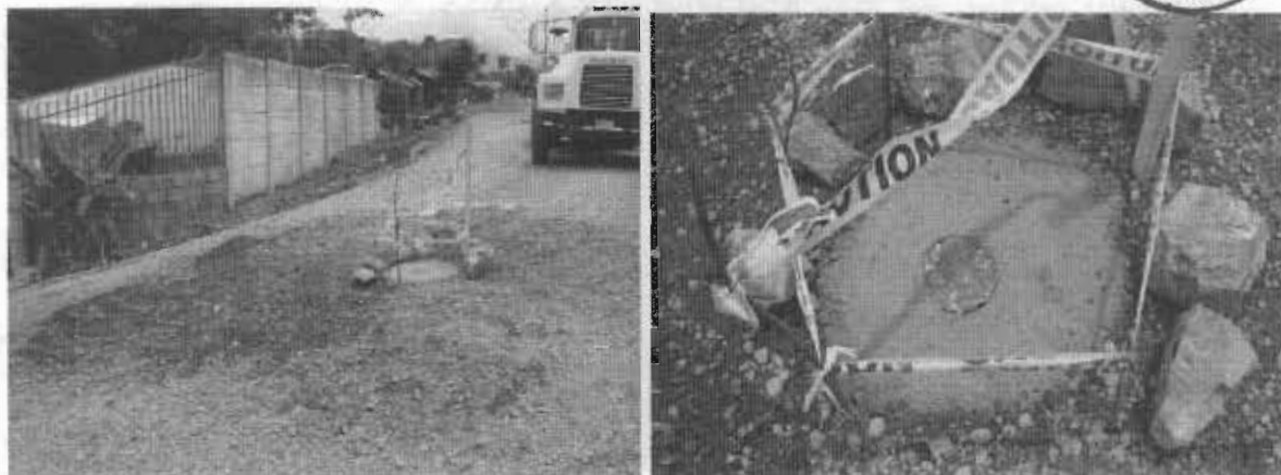
Zona de levantamiento de la válvula de sistema de agua potable (Obsérvese el levantamiento de la capa de base granular ya compactada)
