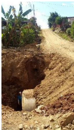
Alcantarillas Barrio El Pocito
