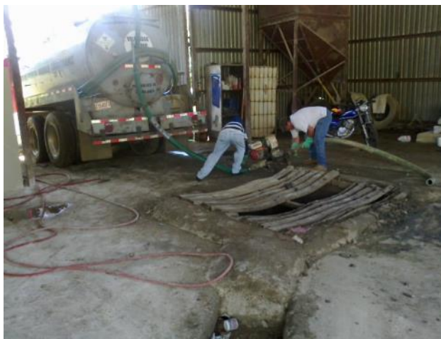
Tanque retenedor de lixiviados en estación de transferencia
